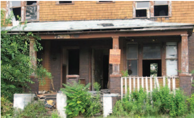
Maison en ruine à Détroit (crédit : Axel Drainville / CC BY-NC 2.0)
